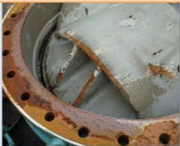
A korrodált pillangószelep – felújítás előtt és után
